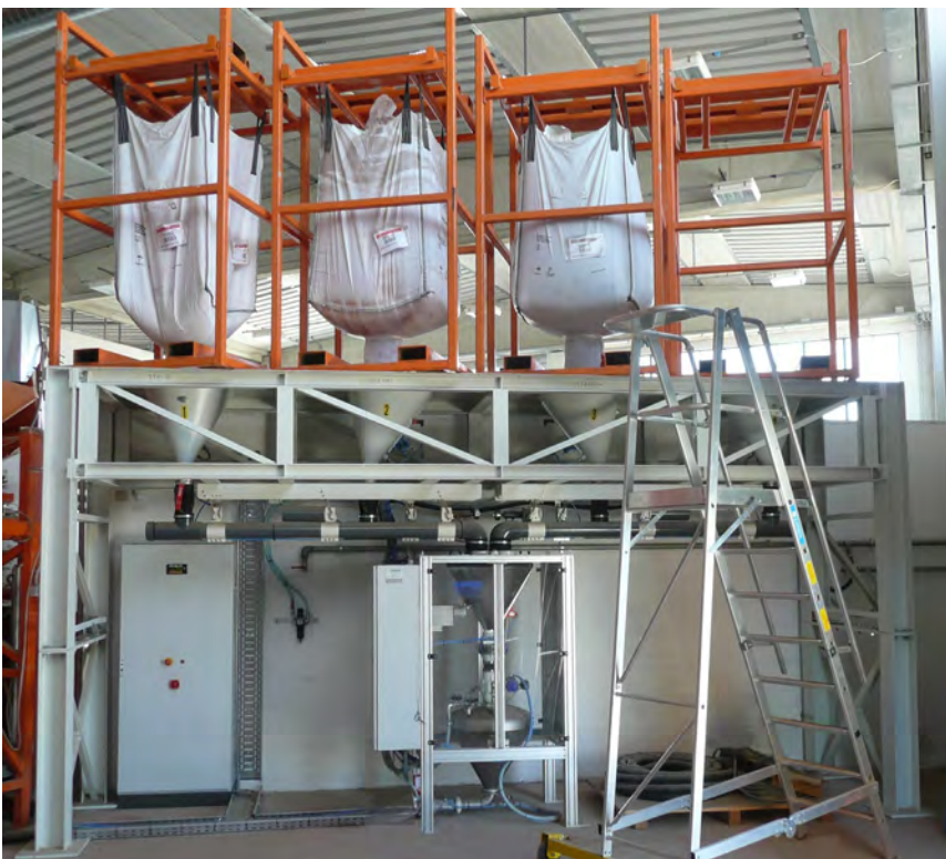
▲ COM 70-1 Granulatdosieranlage mit einem Zwischenbehälter für 4 Farben in 2 Mischer mit einem elektronischen Wiegebehälter
